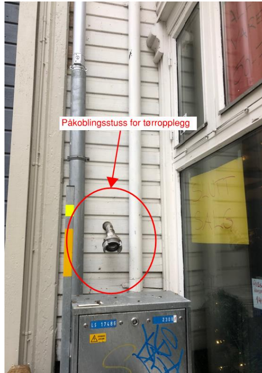
Påkoblingsstuss mot Storgaten.
