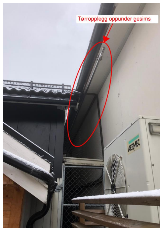
Tørroplegg montert på gesimskasse.
