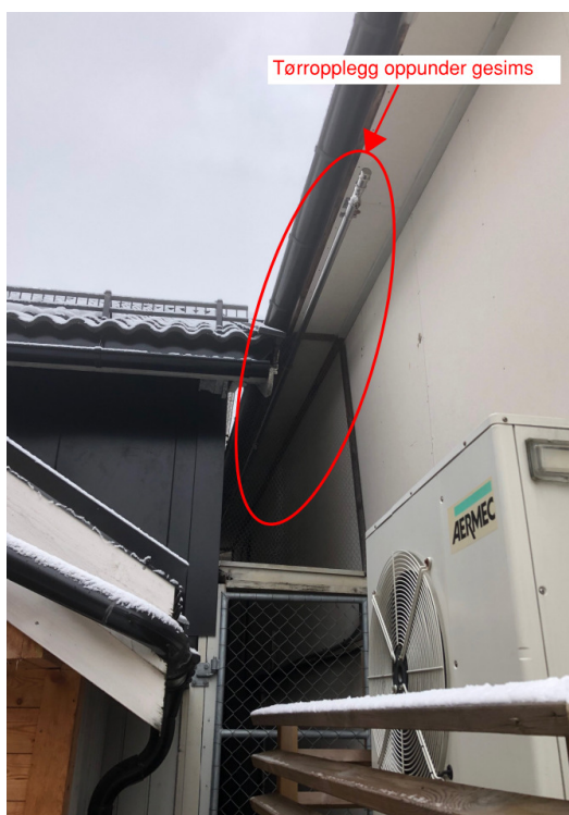
Tørroplegg montert på gesimskasse.
