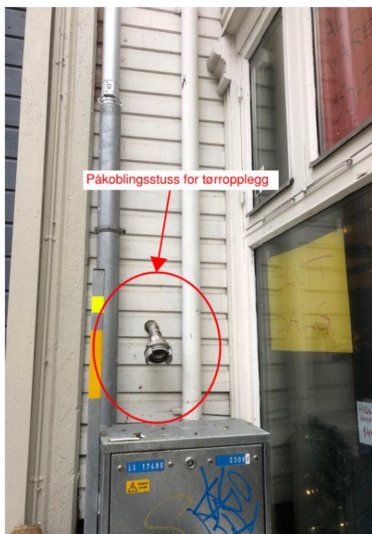
Påkoblingsstuss mot Storgaten.
